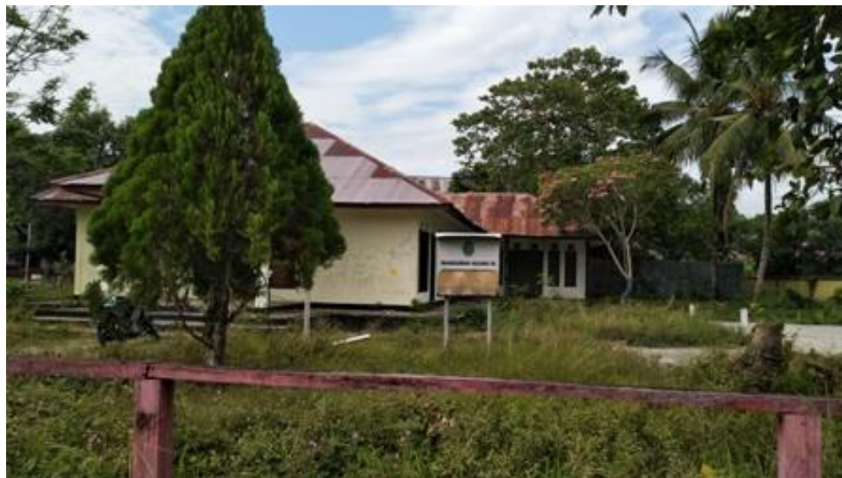
Kondisi Kantor Sebelum Direhab dan ditempati
